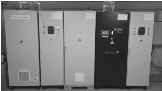
Rys. 6. Wewnętrzny magazyn energii elektrycznej o pojemności 300 kW·h
