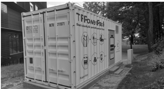
Rys. 7. Zewnętrzny kontenerowy magazyn energii elektrycznej o pojemności 500 kW·h
