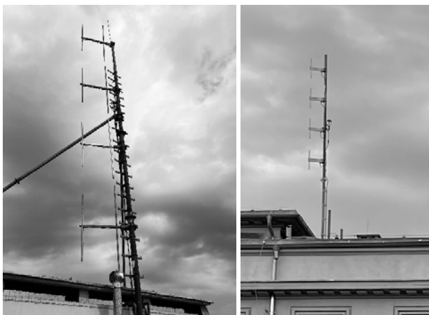
Rys.4. Systemy antenowe: po lewej - UKF FM studenckiego Radia LUZ (dach budynku C-5 Politechniki Wrocławskiej), po prawej -DAB+ LokalDAB (dach budynku Radia Wrocław)
