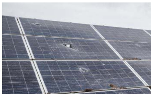
Rys. 1. Zniszczone panele PV w wyniku ostrzału.
