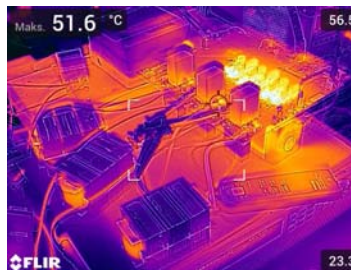
Rys.10. Analiza termiczna przekształtnika w stanie termicznym ustalonym przy pracy z mocą P = 15 \text{ kW} : (a) pomiar temperatury tranzystora w stanie termicznym ustalonym; (b) pomiar temperatury dławików filtra sieciowego oraz rezystorów bramkowych
