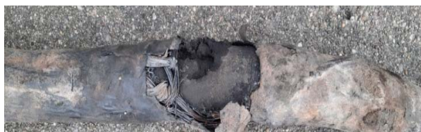
Rys.1. Przykład uszkodzonej mufy kablowej wykonanej na kablu typu XRUHAKXS 1x240/50 mm 2
