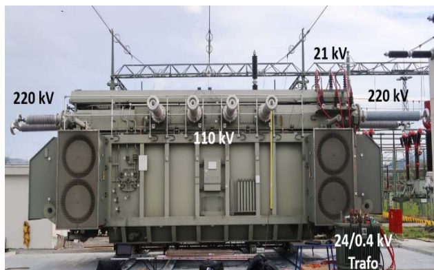
Rys.1. Obiekt badań wraz z transformatorem podwyższającym napięcie
