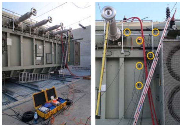
Rys.5. Widok zainstalowanych akustycznych sond piezoelektrycznych
