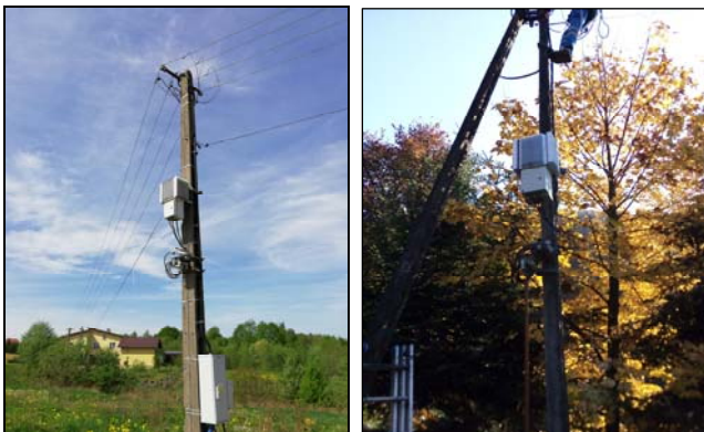
Rys. 6. Widok transformatora symetryzującego zawieszonego na słupie sieci niskiego napięcia w miejscowości A (po lewej) i B (po prawej)
