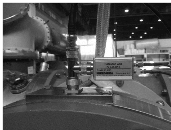
Rys.10. Sonda wnz z detektorem, zainstalowana na oknie dielektrycznym jednego z przedziałów izolacyjnych rozdzielnic gazowej OPTIMA 145
