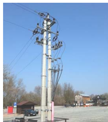
Rys.8. Metody ochrony przed polem magnetycznym w otoczeniu słupów kablowych a - słup kablowy 110 kV zabezpieczony obudową blaszaną i nasadzoną zielenią, b - słup kablowy średniego napięcia otoczony metalowym płotkiem
