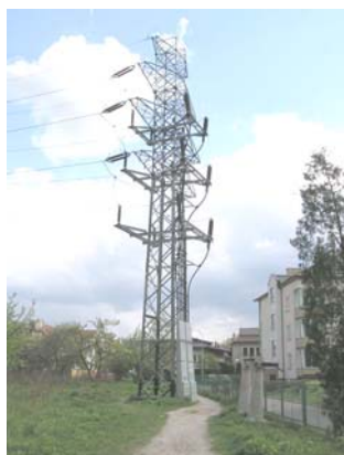
Rys.7. Słup kablowy bez zabezpieczenia bezpośredniej dostępności, usytuowany w bliskim sąsiedztwie zabudowy mieszkaniowej
