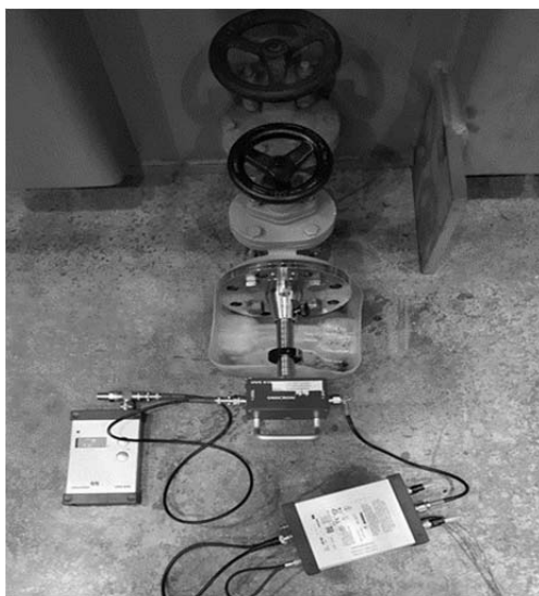
Rys.5. Instalacja anteny UHF z wykorzystaniem zaworu spustowego oleju w transformatorze (widoczny od lewej: generator sygnału, antena UHF, układ adaptacji częstotliwości)
