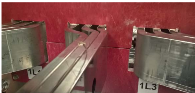
Rys.10. Termopara umieszczona na środkowej fazie przyłączy klienta
