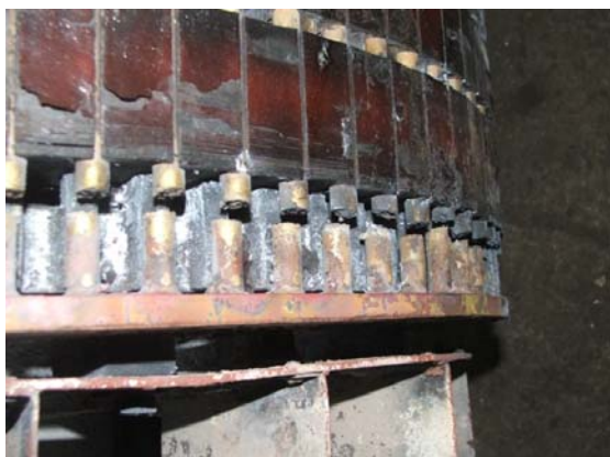
Rys. 1. Wypalone pręty klatki rozruchowej w strefie pozapakietowej silnika 580 kW
