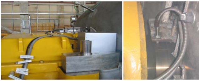
Rys.4. Widok turbozespołu dużej mocy z zaznaczonym węzłem łożyskowym Nr 1 (u góry) oraz zbliżenia pokazujące czujnik LVDT (z lewej) oraz dwa czujniki wydłużeń wału (z prawej).
