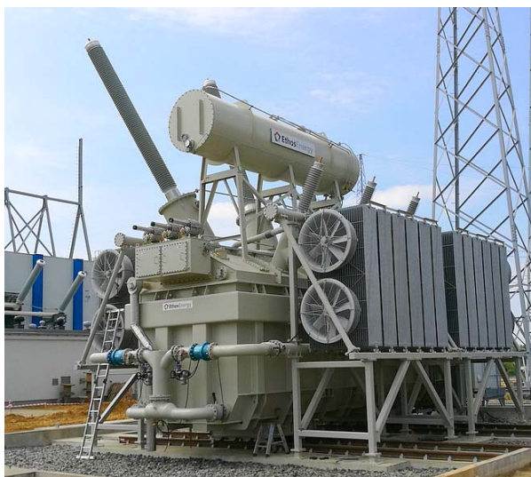
Rys. 10. Autotransformator ANER3La 330000/410 na stanowisku pracy
