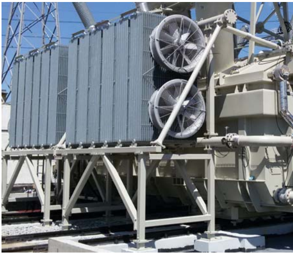
Rys. 6. Widok układu chłodzenia autotransformatora ANER3La 330000/410
