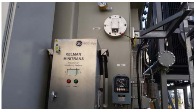
Rys. 9. Układ do monitorowania zawartości wody i gazów oleju wraz z czujnikiem wyładowań niepełnych
