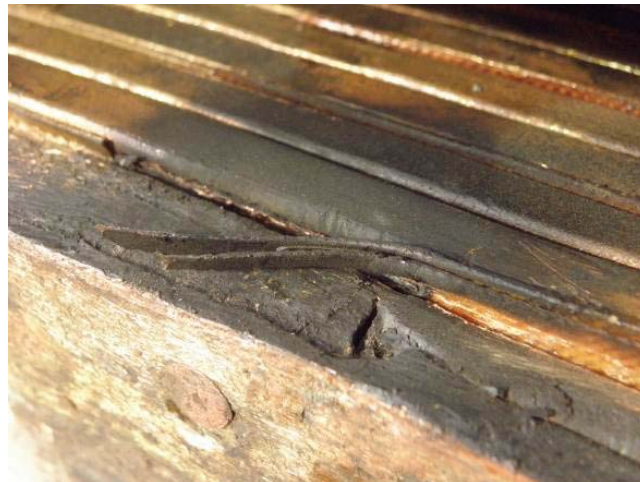
Rys. 13. Przykładowe uszkodzenie izolacji.
