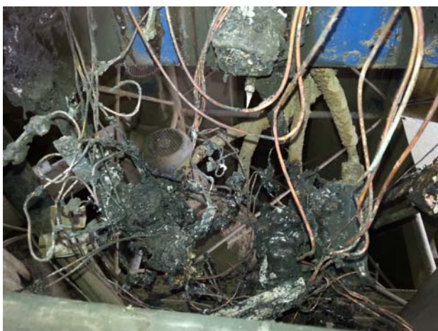
Rys. 8. Pożar spowodowany eksplozją ogranicznika przepięć
