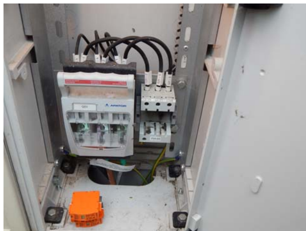
Rys. 9. Rozdzielnica niskiego napięcia z widocznymi śladami po eksplozji ogranicznika przepięć
