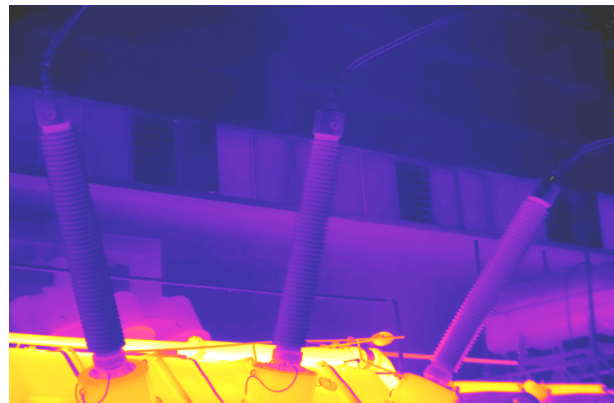
Rys.6. Przykład diagnostyki termowizyjnej przepustów izolatorowych
