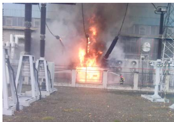
Rys.1. Pożar transformatora blokowego
