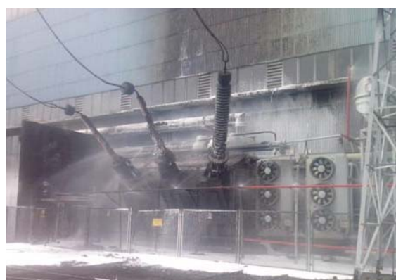
Rys.2. Transformator bezpośrednio po ugaszeniu pożaru
