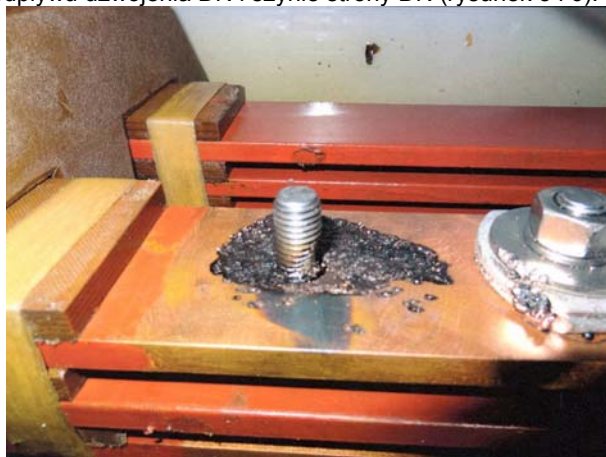
Rys. 6 Wypalenia na szynie DN transformatora.
