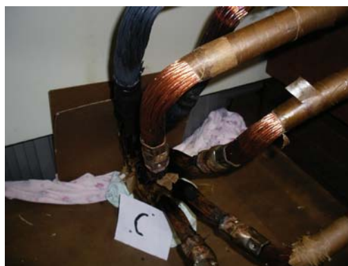
Rys. 4 Widok przegrzanych linii na końcówkach faz A, B, C na uzwojeniu DN.
