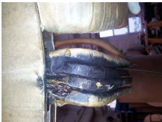
Rys 20 Widok odpływu z widocznym wypaleniem od łuku elektrycznego.
