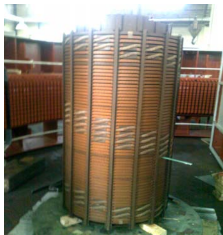
Rys. 8 Widok uzwojenia z zaznaczonym za pomocą klina miejscem występowania zwarcia.
