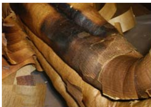
Rys. 3 Widok przegrzanego miejsca na izolacji linki (po zdjęciu kilku warstw papieru).
