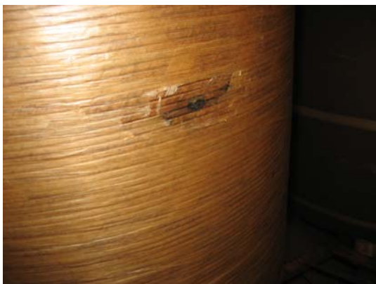
Rys 21 Widok miejsca występowania zwarcia na uzwojeniu regulacyjnym.
