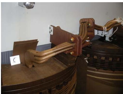
Rys. 2 Widok odpywów z uzwojenia DN faz A, B, C po wyjęciu części aktywnej.
