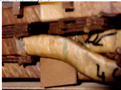
Rys.18. Przesunięcie wkładki izolacyjnej umieszczonej pomiędzy przewodami połączenia cewek 3 i 4 fazy C – miejsce uszkodzenia (widok od strony wewnętrznej).
