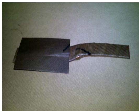
Rys. 9 Widok uszkodzonego przewodu i przesuniętej przekładki preszpanowej.
