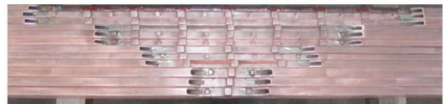
Rys. 3. Zdjęcie części żłobkowej uzwojenia remontowanego generatora GTHW 360
