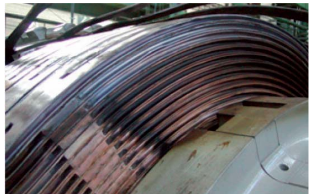
Rys. 4. Zdjęcie czoł uzwojenia wzbudzenia generatora GTHW 360
