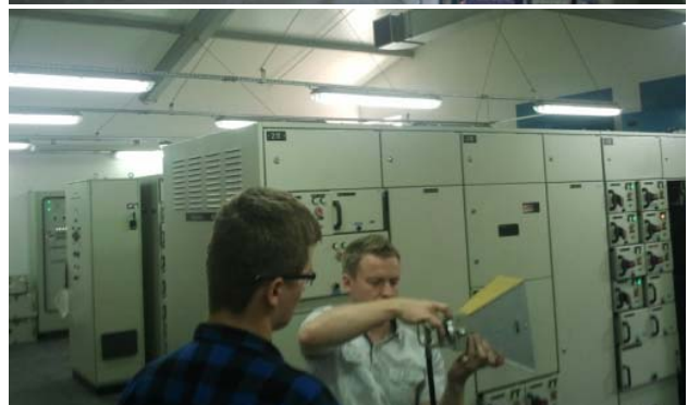
Rys.2. Zdjęcia z pomiarów w rozdzielni OPT-ML-III
