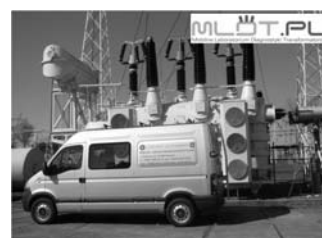
Rys.1. Mobilne laboratorium diagnostyki transformatorów
